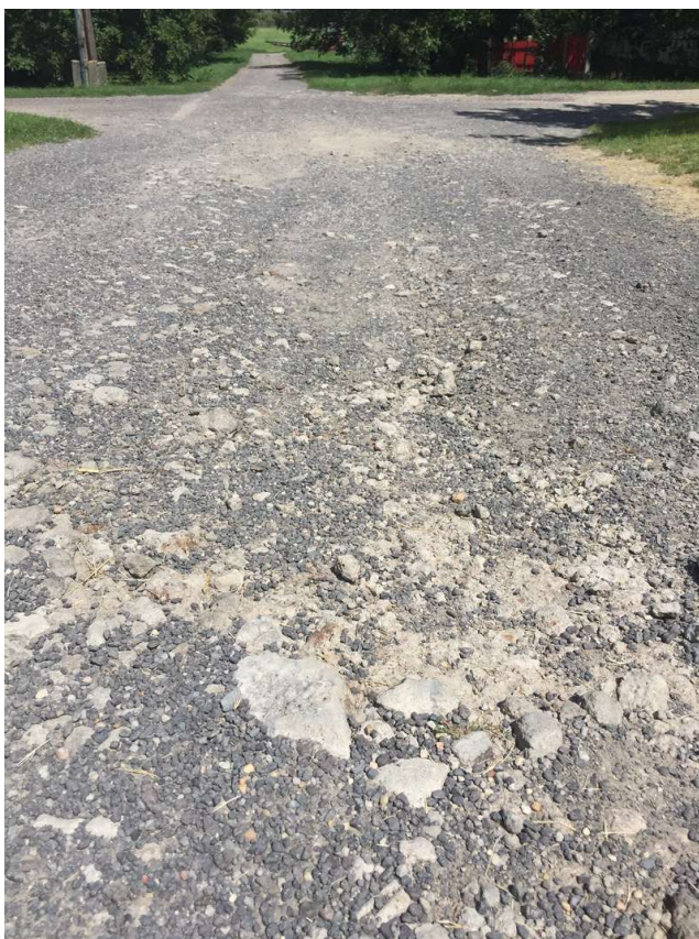
Lokális felületi kimosódás
