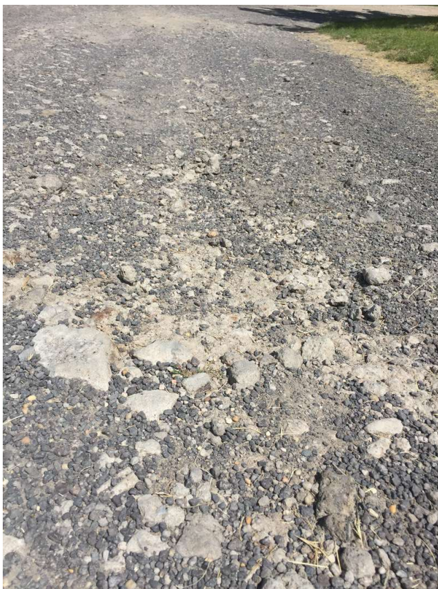
Lokális felületi kimosódás
