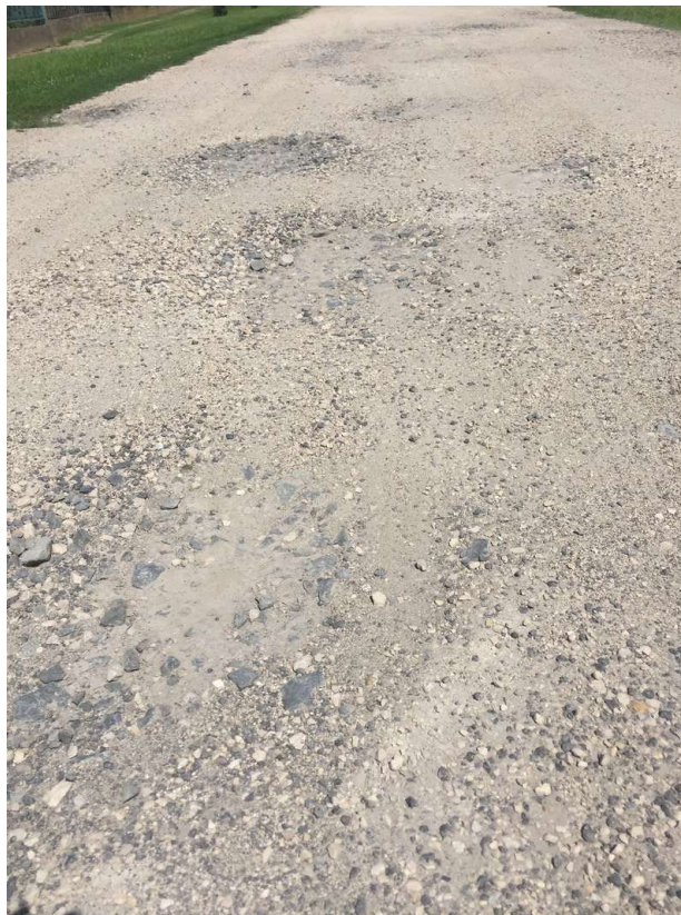
Csatornaszerűen kimosódott útpálya a mélypont közelében
