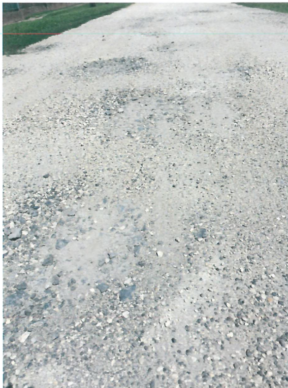
Csatornaszerűen kimosódott útpálya a mélypont közelében
